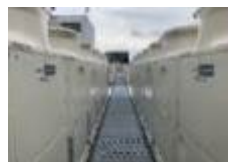
空調設備の更新 (Daiwa銀座ビル)
